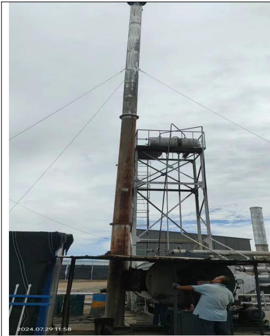
2号排气筒 (DA002)
