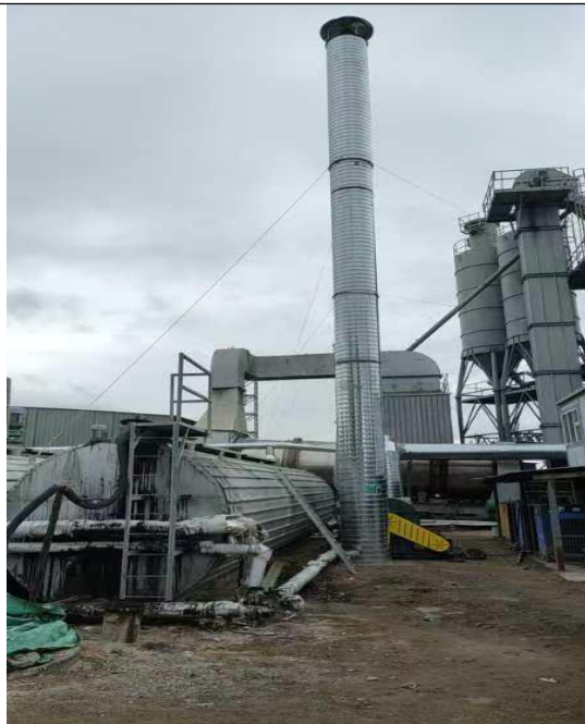
3号排气筒 (DA003)
