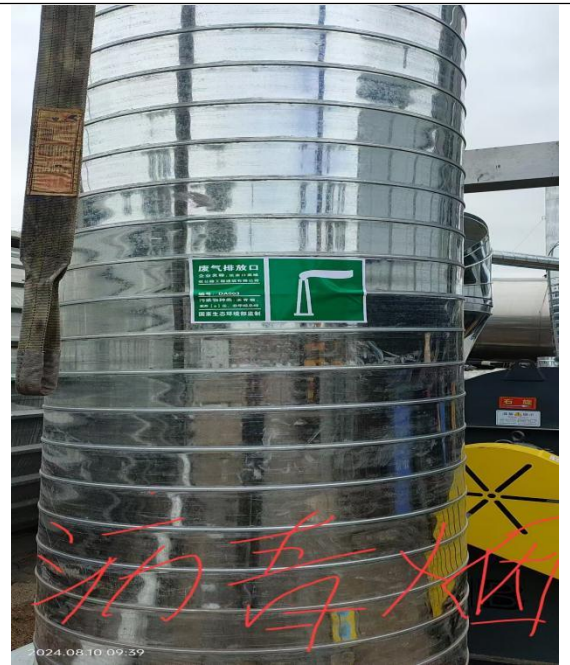
3号排放口标识 (DA003)
