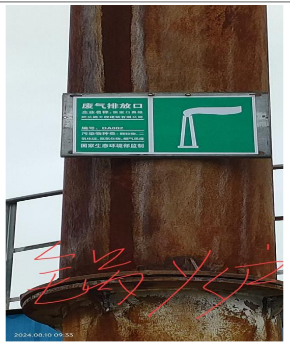
2号排放口标识 (DA002)
